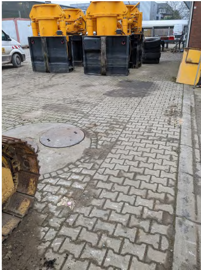
Foto 12: Standort RKS 12 (Leichtflüssigkeitsabscheider neben Waschplatz)
