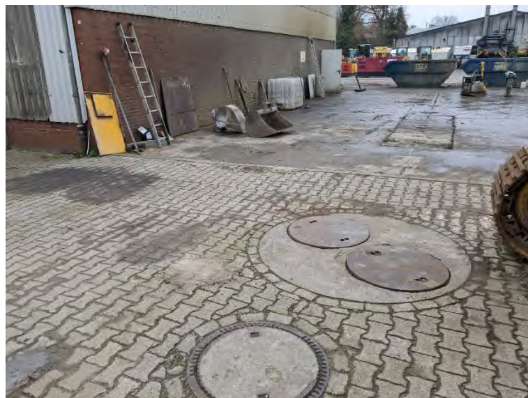
Foto 13: Standort RKS 13 (Leichtflüssigkeitsabscheider neben Waschplatz)
